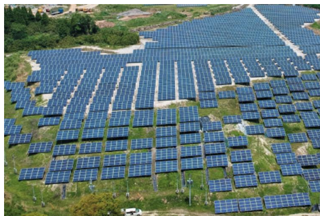
(株)バロース案件 国東太陽光発電所(大分県国東市)
